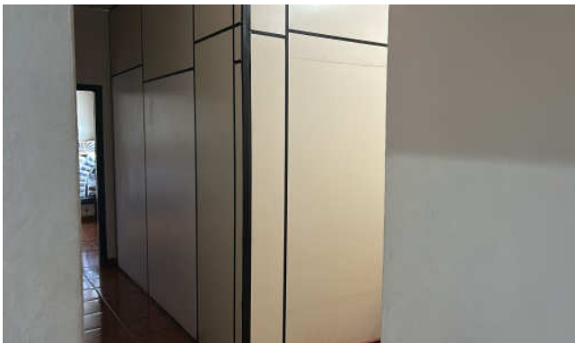
F 07 – Detalhe de divisórias em madeira que serão trocadas por paredes drywall.
