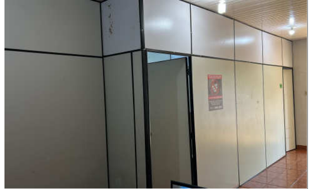
F 06 – Detalhe de divisórias em madeira que serão trocadas por paredes drywall
