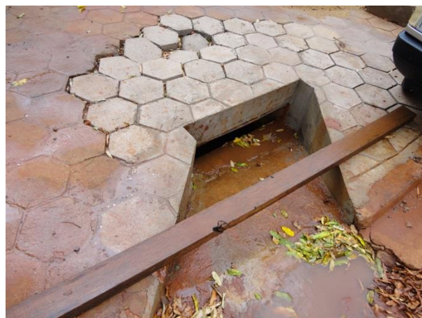
Foto 6.6 - Boca de Lobo simples da Rua Bahia
