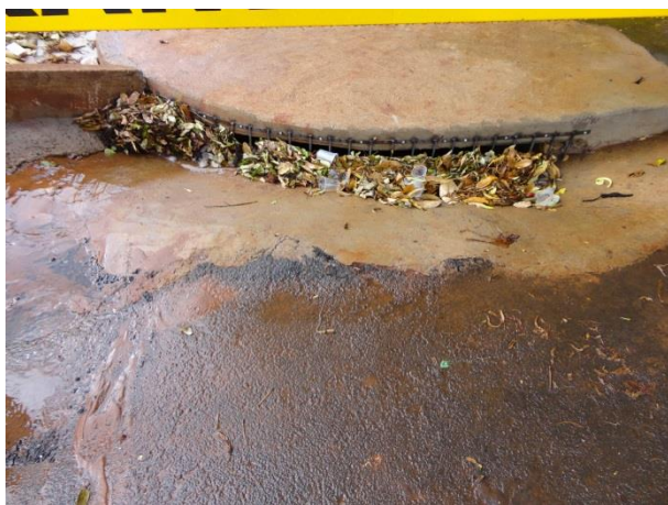
Foto 6.9 – Boca de lobo entupida no ponto de alagamento entre a Rua Bahia e a Rua São José
