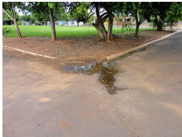
Foto 6.8- Ponto de Alagamento entre as Ruas Guanabara e Paraná
