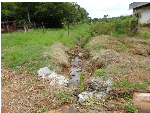
Foto 6.5 – Dissipação da galeria da Rua Mato Grosso
