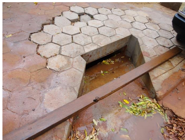
Foto 3.6 - Boca de Lobo simples da Rua Bahia
