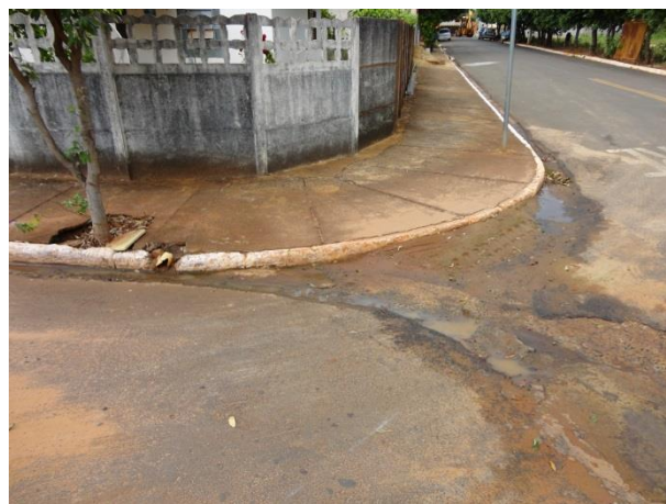
Foto 3.10 – Ponto de Alagamento entre as ruas Mato Grosso e Treze de Maio
